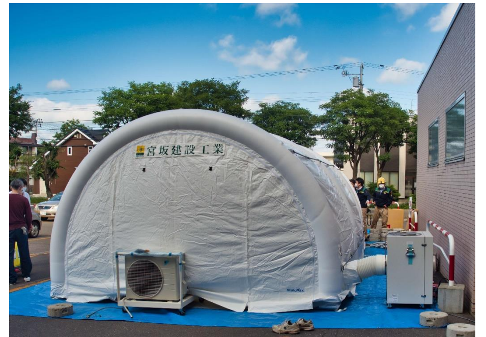
東側駐車場に設置された医療用陰圧テント
